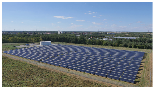
Abb. 14: Kollektorfeld und Wärmeübergabestation (WÜST)
