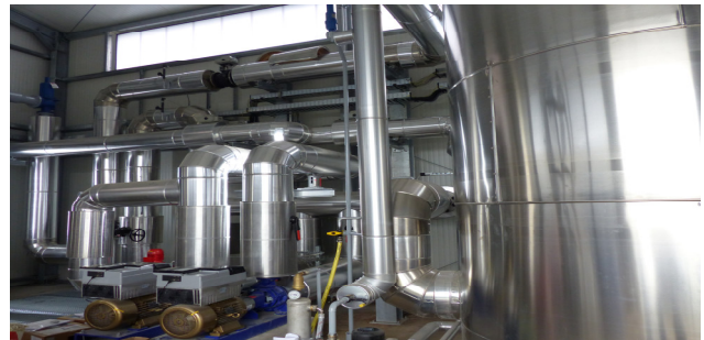
Abb. 13: Die Solarpumpen neben der hydraulischen Weiche
